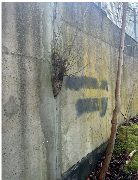
Przejsię pnia drzewa przez dylatację ściany oporowej
