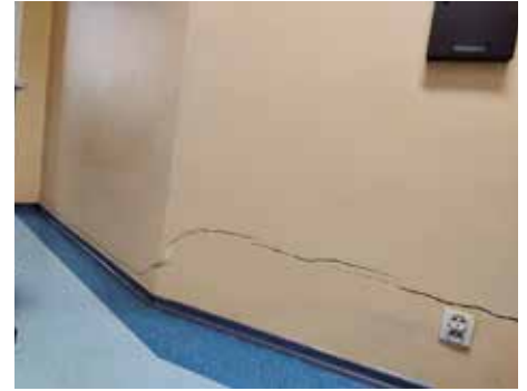
Zapadnięta ściana wraz z posadzką
