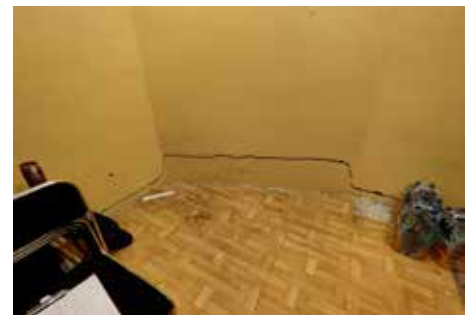
Obniżona posadzka z fragmentem odspojonej obniżonej ściany działowej
